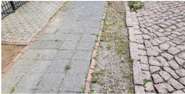
Abbildung 37: Zustand der Fußwege Birkenweg
