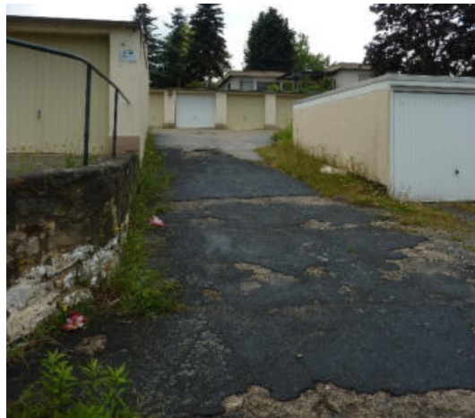
Abbildung 23: Stark sanierungsbedürftige Garagenflächen Glockbergstr.
