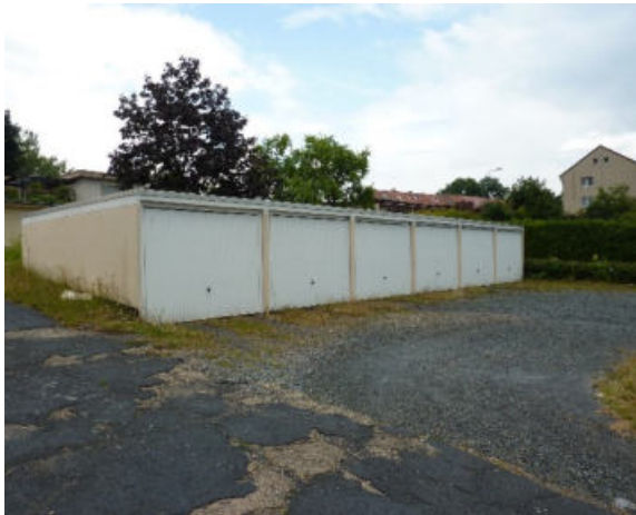
Abbildung 22: Stark sanierungsbedürftige Garagenflächen Glockbergstr.
