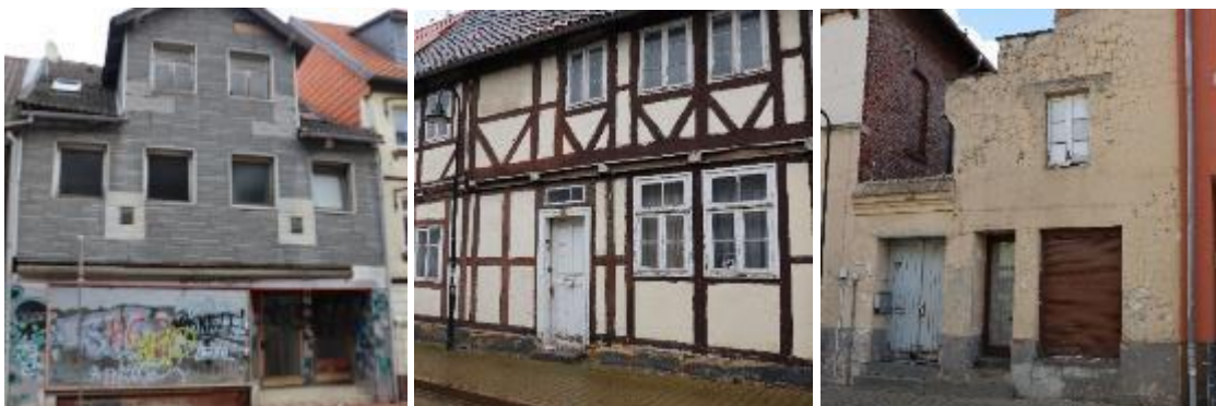
Abb. 11 Gebäude mit Sanierungsbedarf
