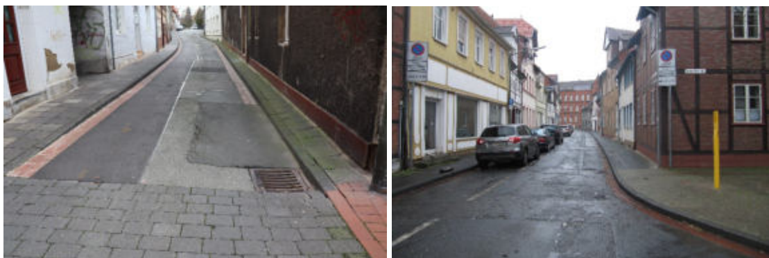
Abb. 27 sanierungsbedürftige Straßenbelag der Walpurgisstraße (rechts) und Bötticherstraße (links)
